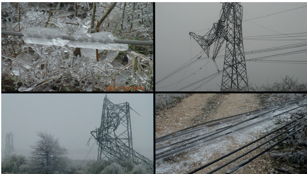
1.15. ábra. Az ónos eső okozta jéglerakódás, illetve a helyenként 6 tonna plusz teher alatt összerokkadt tartóoszlopok Gödöllő térségében. (MAVIR felvételei).
